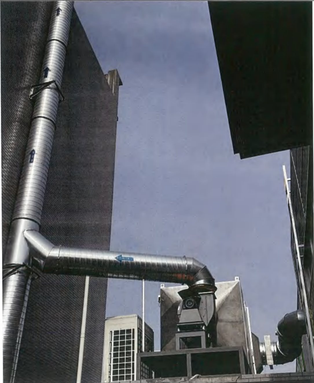
图 3-1 废气处理设备照片
