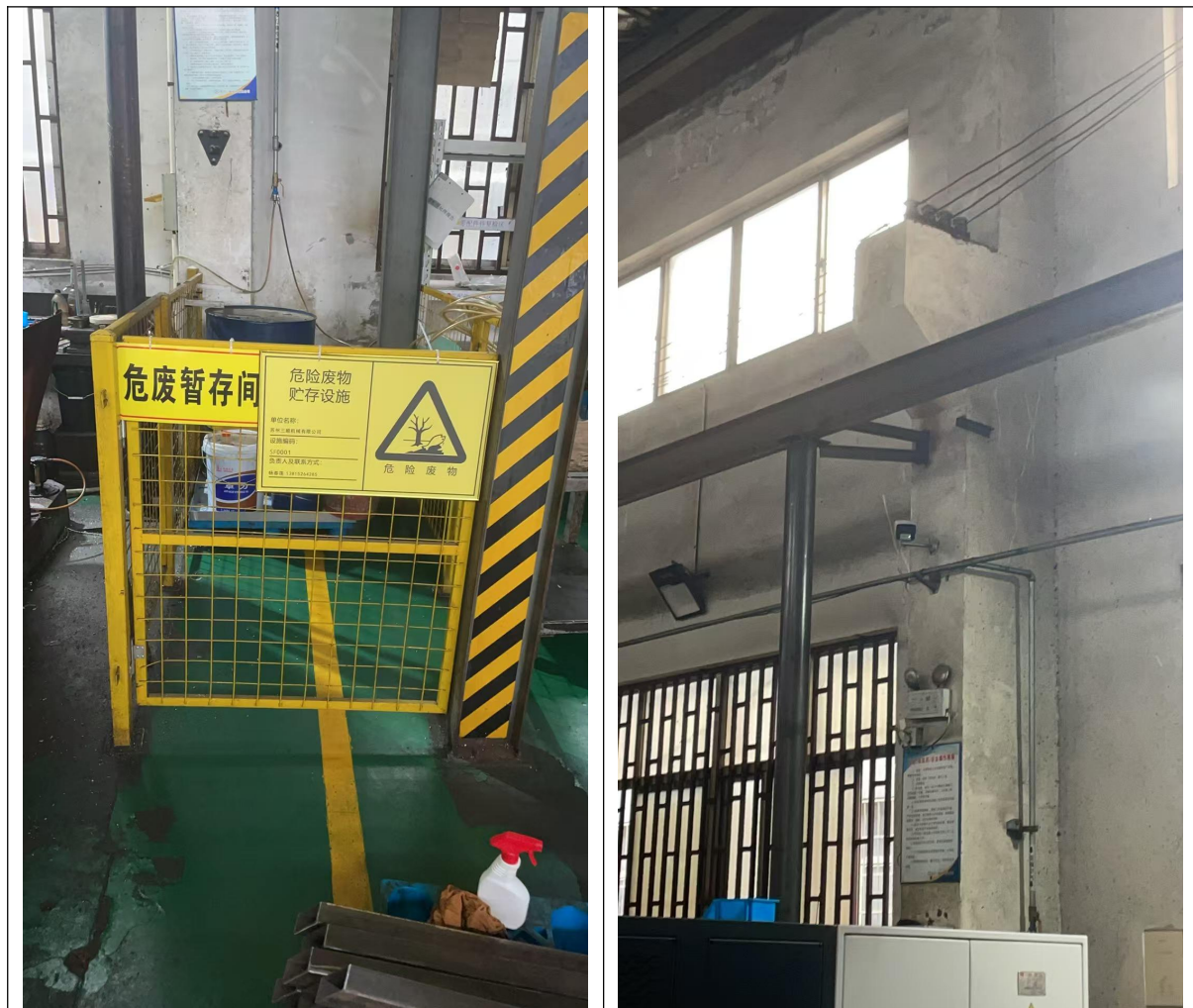
图3-2危废贮存区照片
