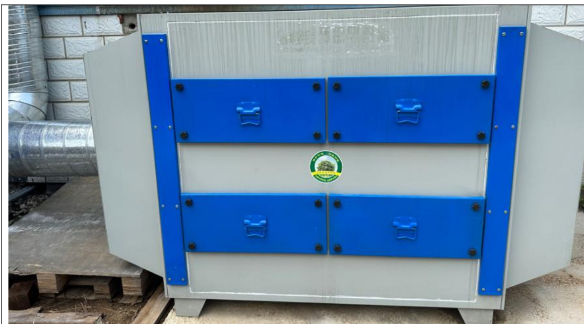
图 3-3 项目非甲烷总烃处理设备图
