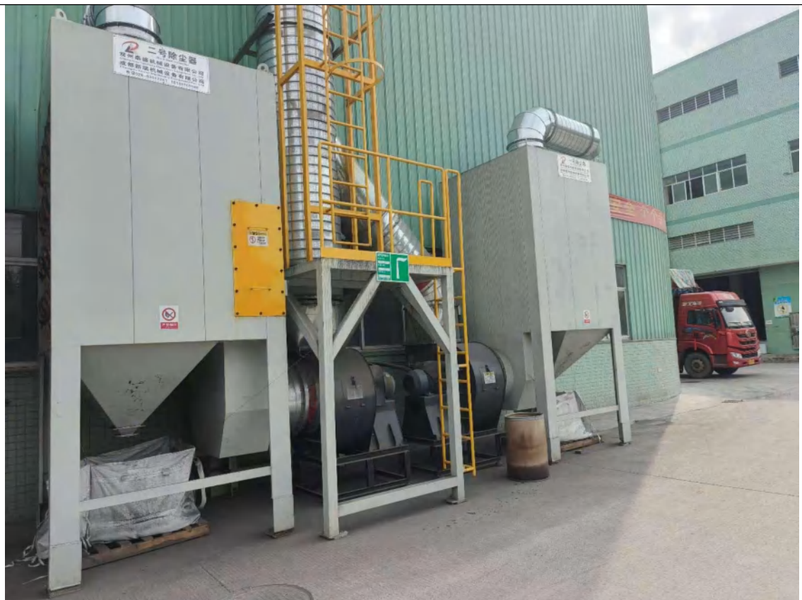
TA001 废气处理设施（2套滤筒除尘器并联），DA001 排放口
