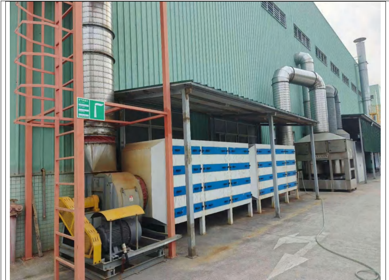
TA003 废气处理设施（水喷淋+过滤棉+两级活性炭吸附），DA002 排放口
