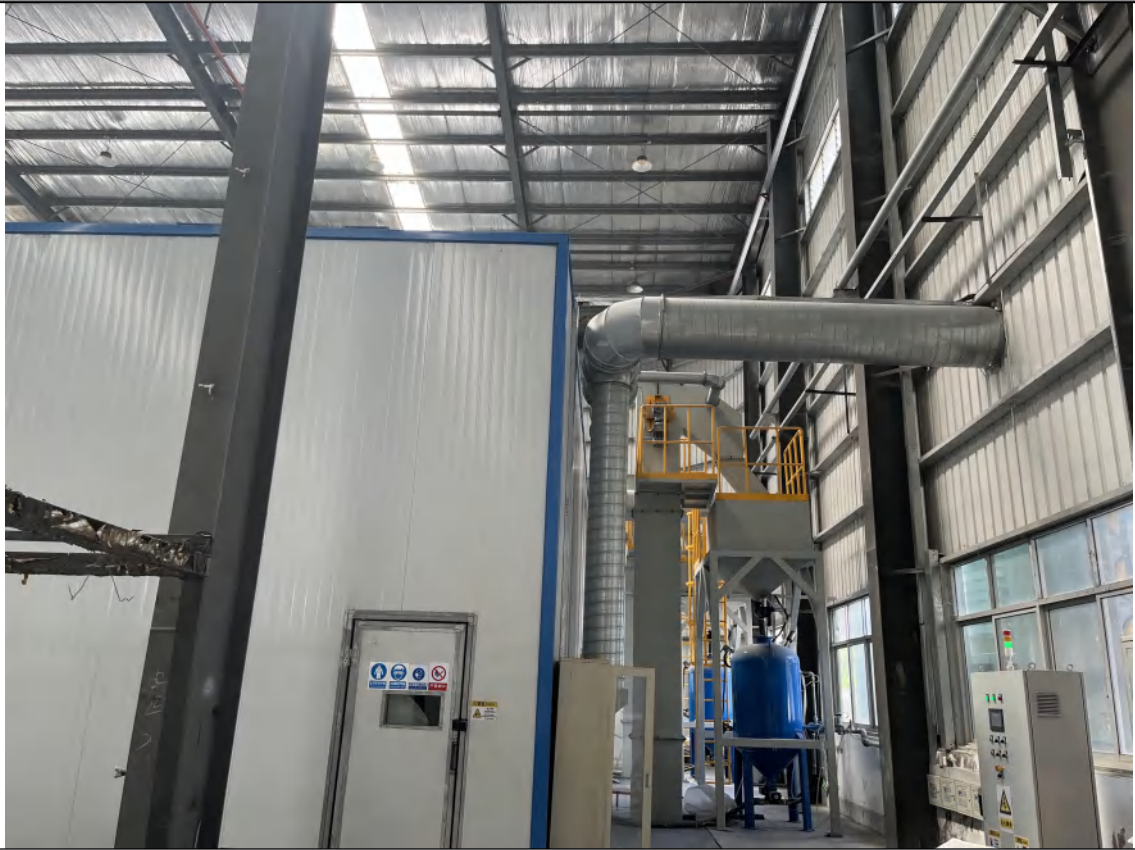
废气收集管道
