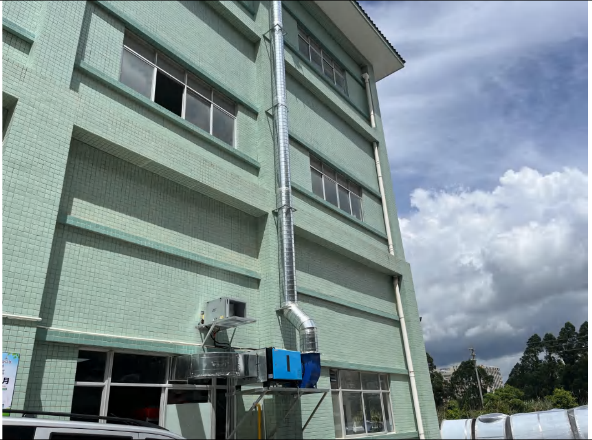
TA004 废气处理设施（静电油气净化器），DA003 排放口
