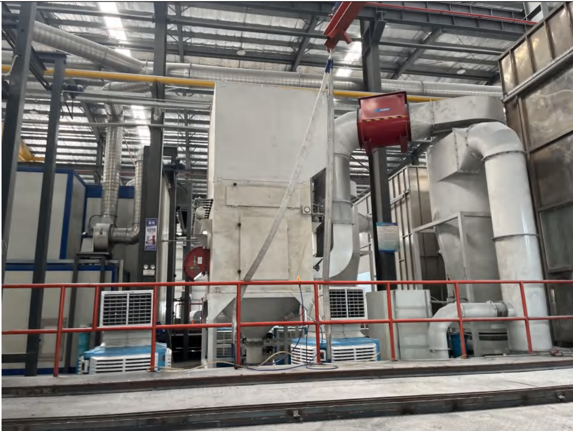
废气收集管道
