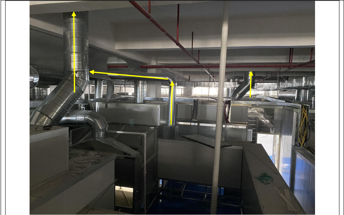
喷涂线上方废气收集
