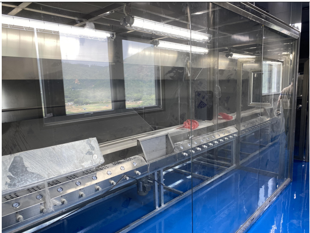
自动喷涂线水帘柜
