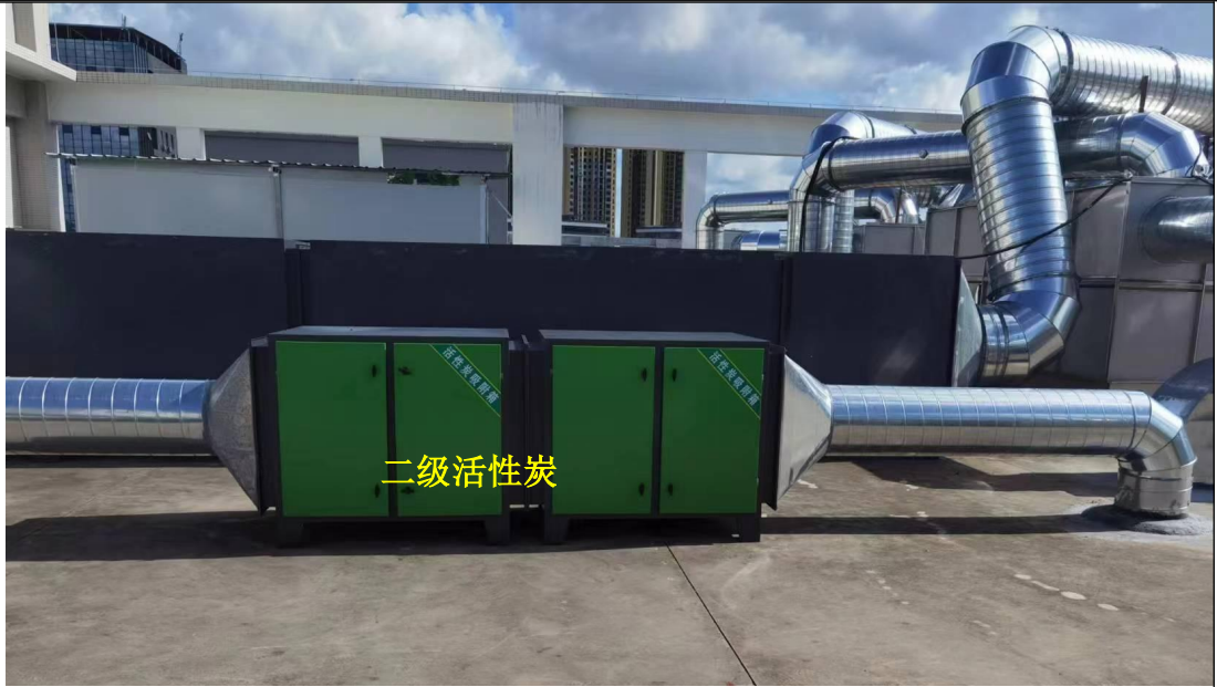
印刷/调漆房废气治理设施
