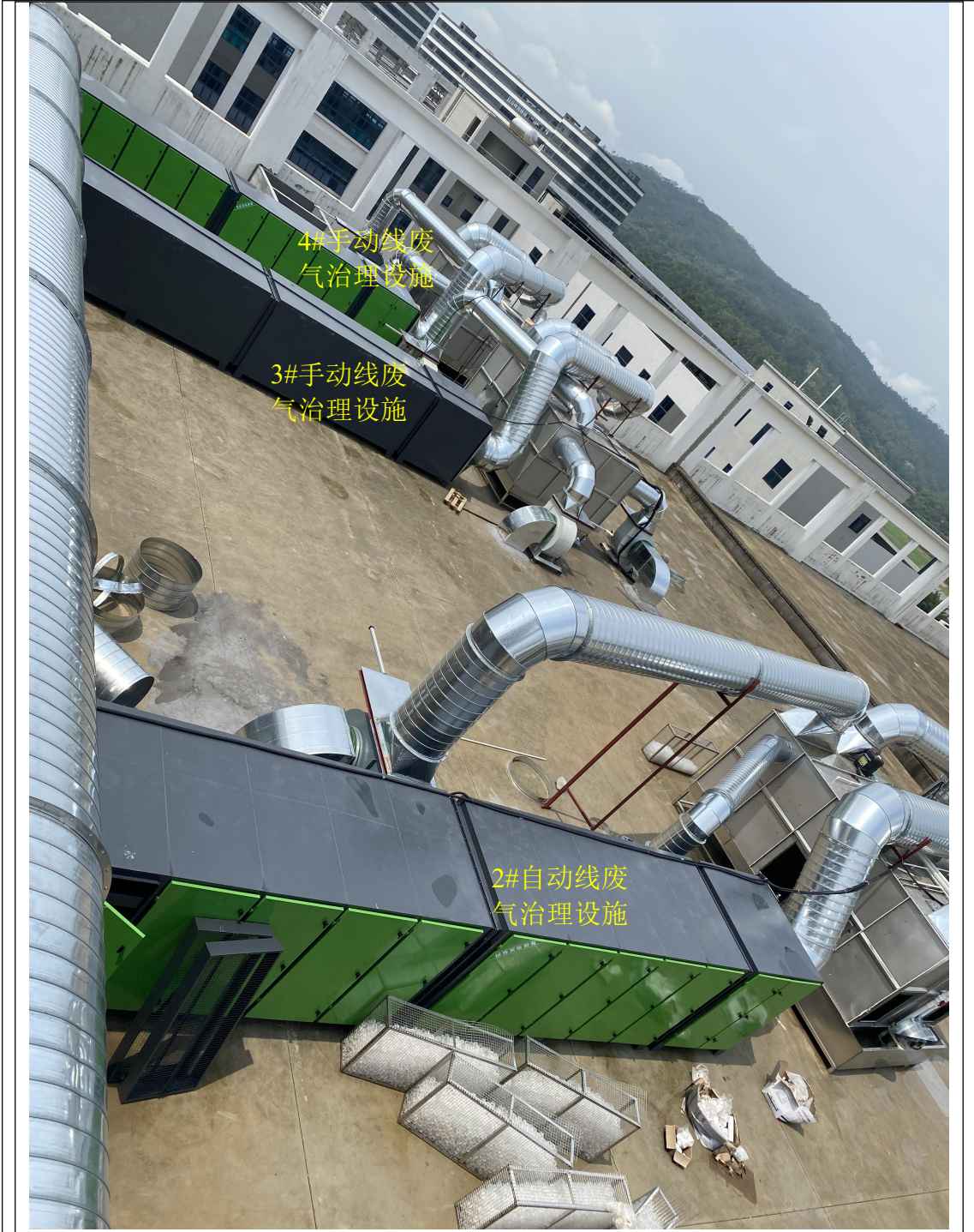
废气处理设施俯瞰图
