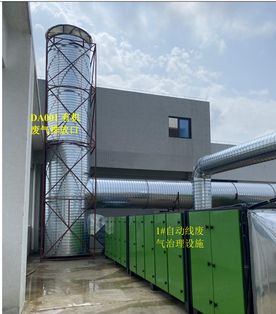
废气排放口照片
