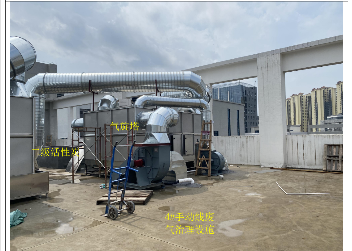
4#手喷 UV 漆线废气治理设施
