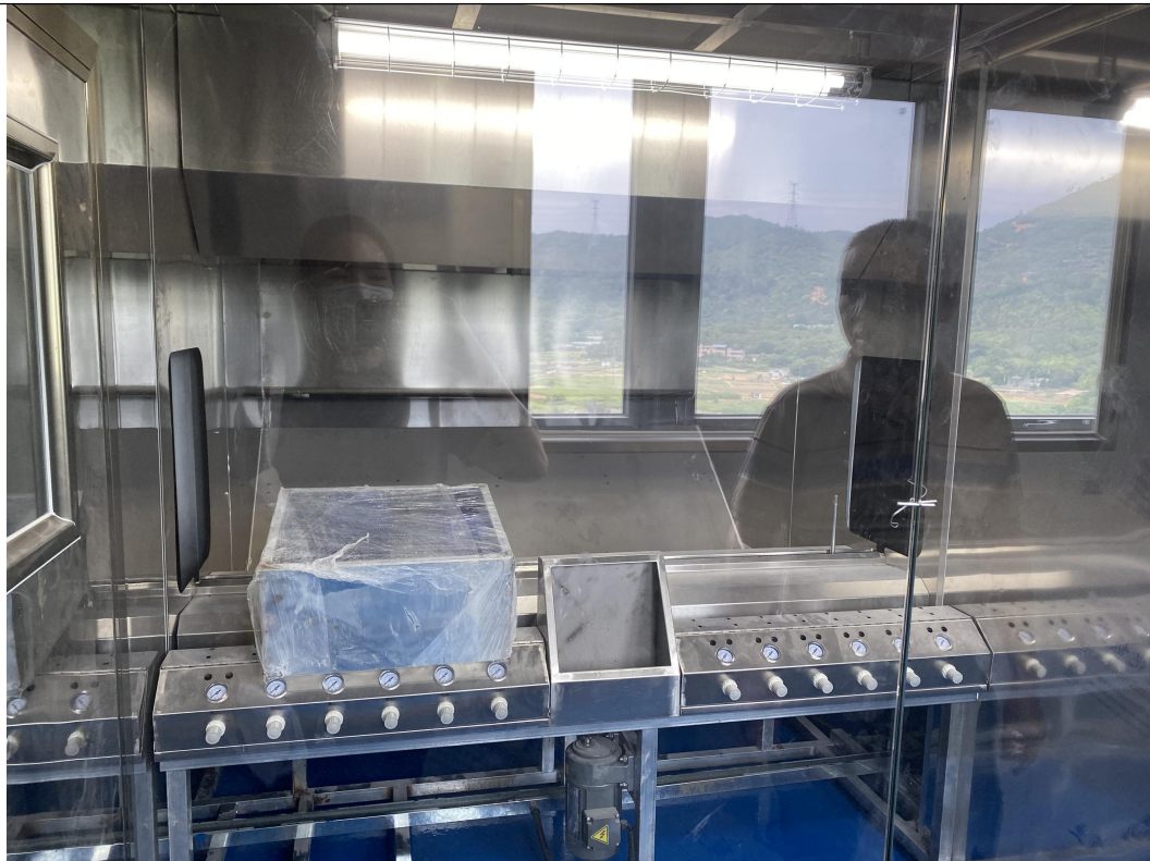
自动喷涂线水帘柜
