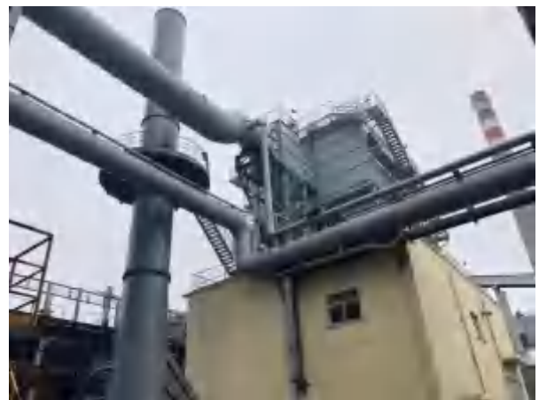
干熄焦环境除尘地面站
