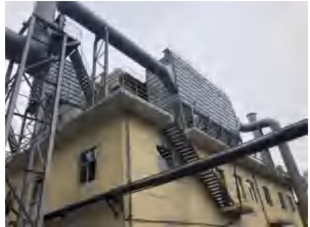
装煤、拦焦除尘地面站
