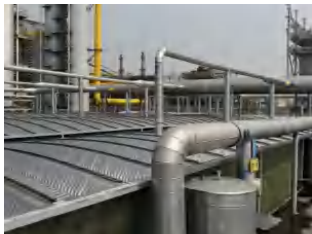
生化站密闭及臭气收集系统
