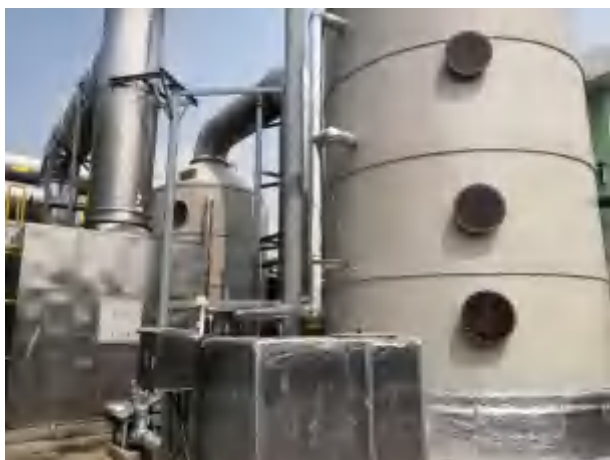
生化站除臭装置
