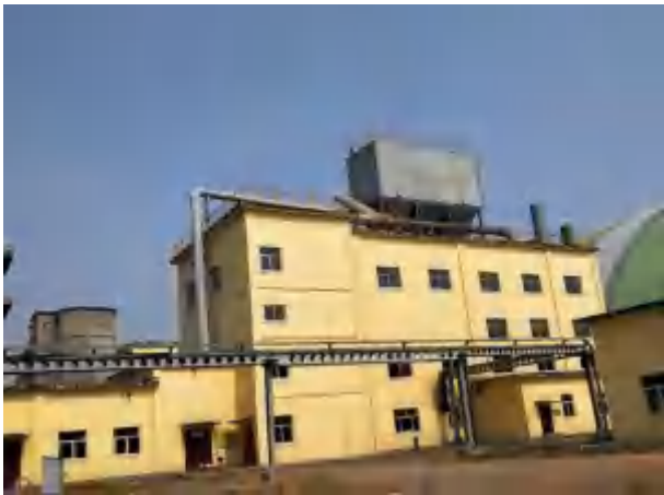
精煤预破碎除尘
