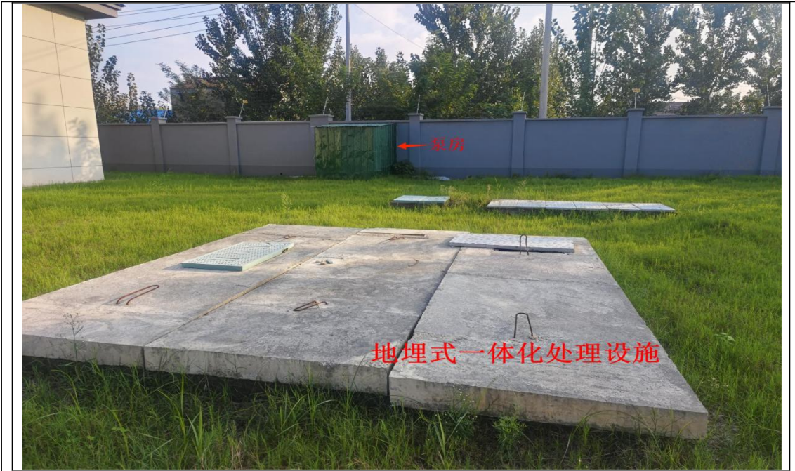
图 3.1-2 地埋式一体化废水处理设施照片
