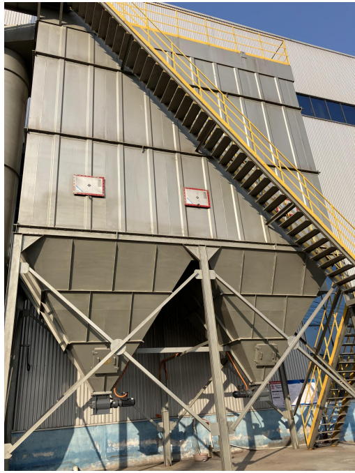
浇注工序“布袋除尘器”
