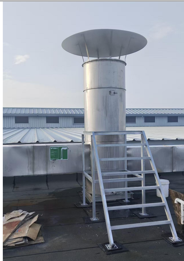
油烟废气排放口DA007
