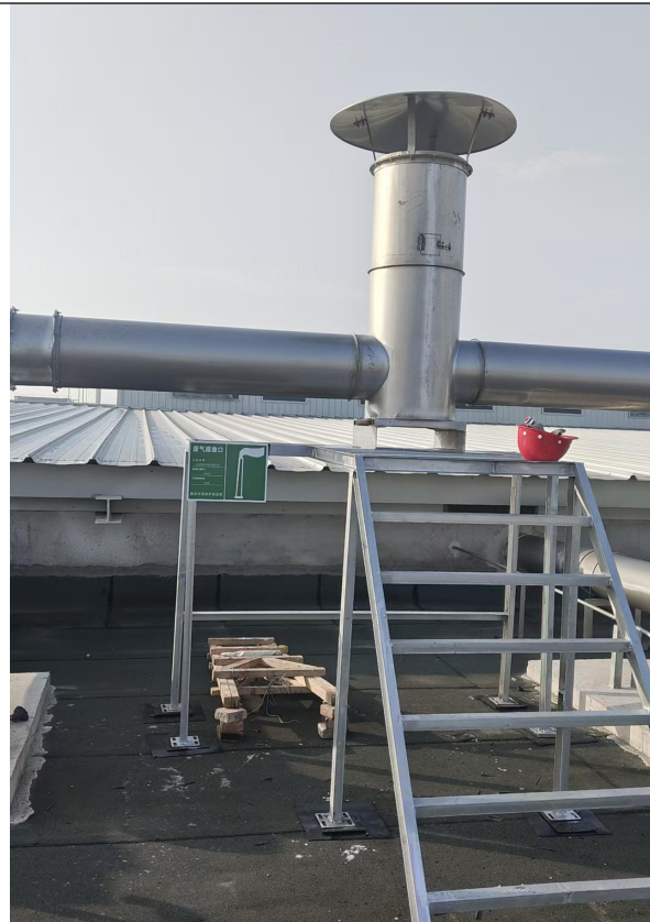
油烟废气排放口DA008
