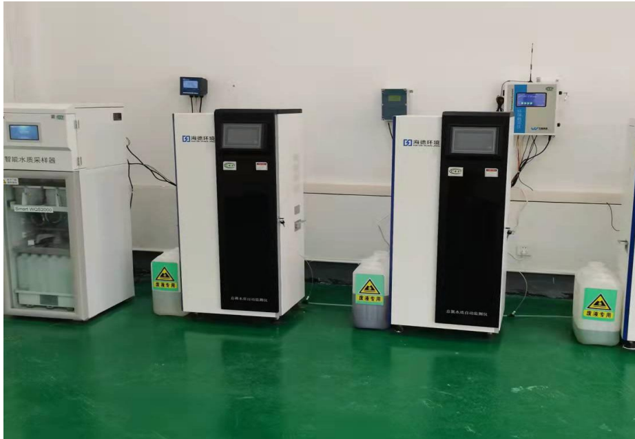
图 4.1-8 厂区污水排放口在线监测装置
