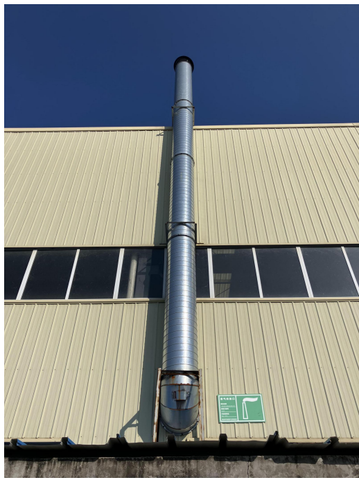
DA002 排气筒及标识牌
