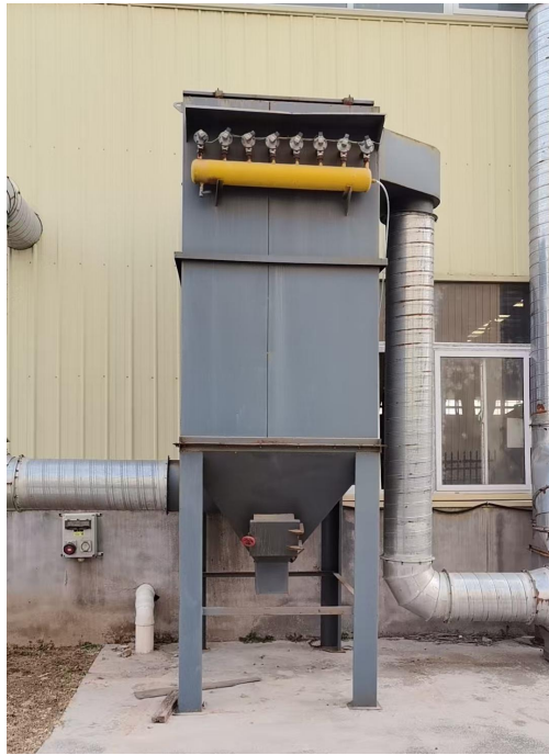
切割工序布袋除尘器
