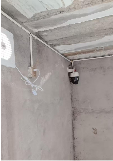
危废间内部监控
