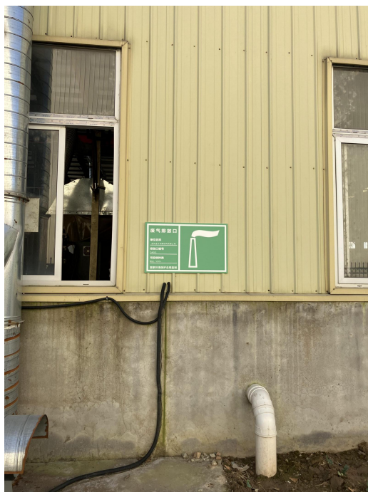
DA001 排气筒标识牌
