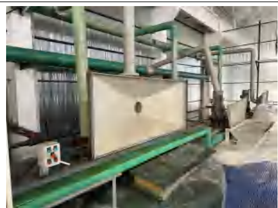
搅拌罐上方集气装置
