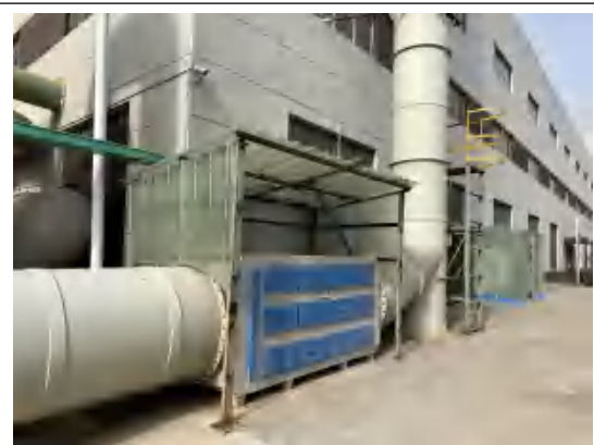
危废库废气活性炭设备
