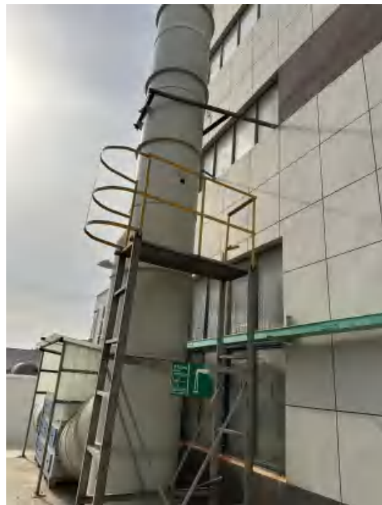
危废库废气排气筒
