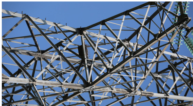
图片来源：衢州市供电公司
