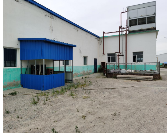
冷藏库、速冻库
