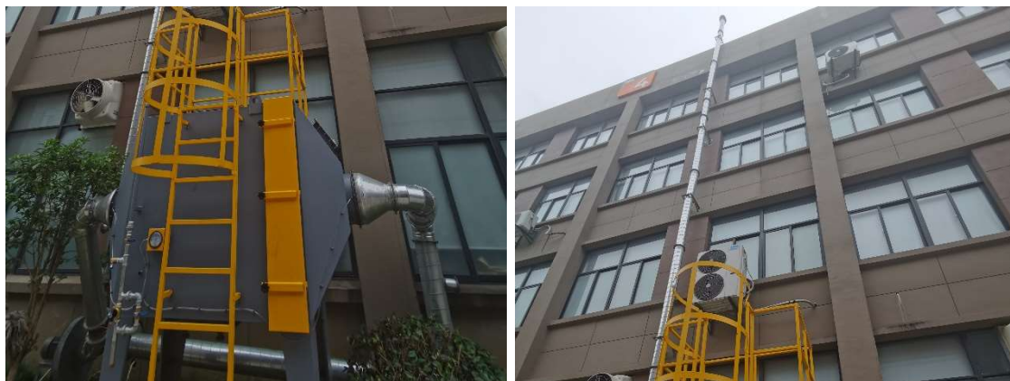
活性炭吸附装置处理设备现场图（位于 4 号楼西侧）
