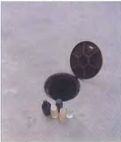
生活污水排放口
