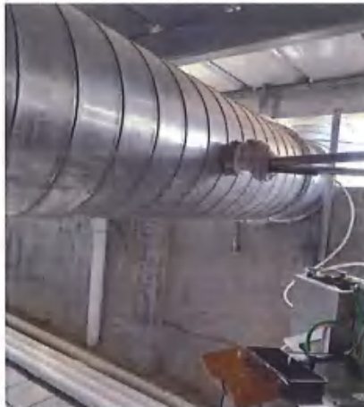
印刷胶辊生产工序废气排放口
