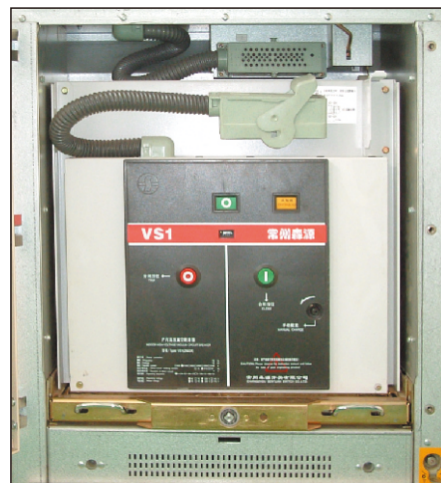
图4.2 真空断路器手车在柜内试验位置
