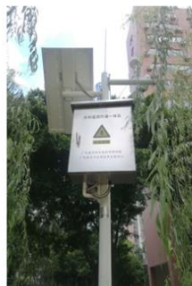
广东清远水利监控项目
