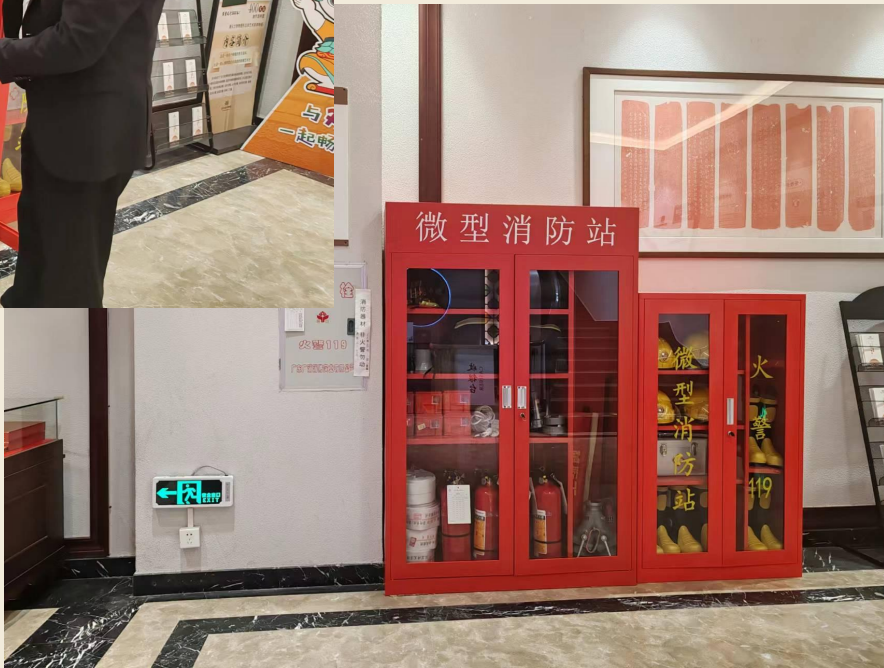
我馆新购置的新标准微型消防站
