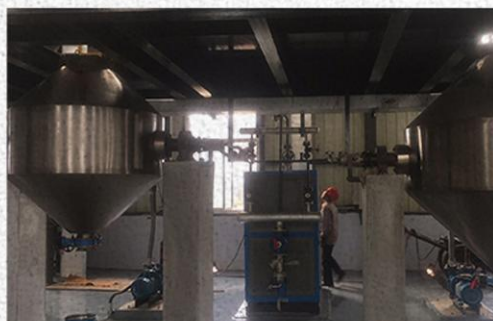
混料机导热油炉
