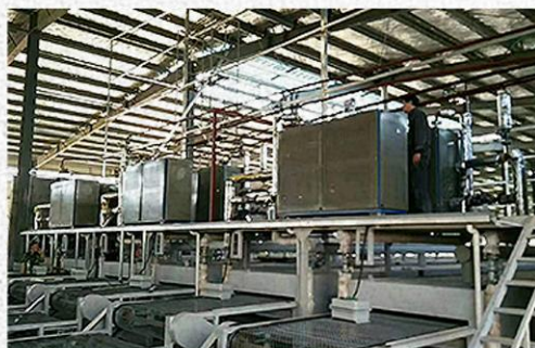
隧道烘箱加热现场
