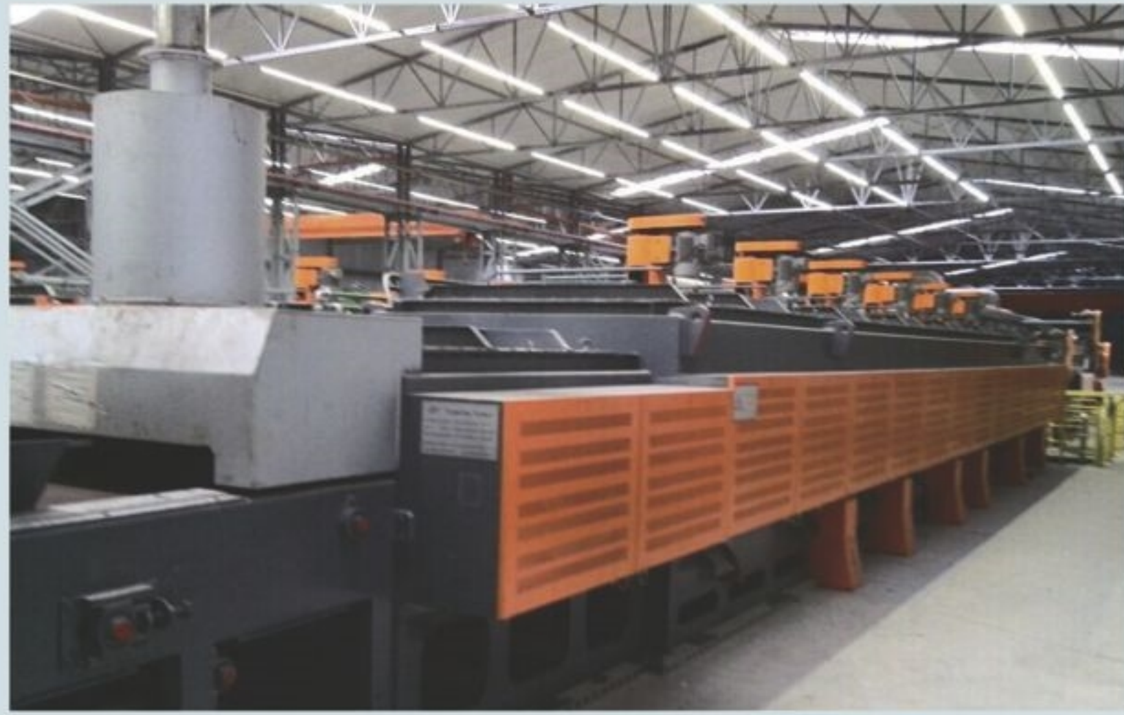
自动热处理车间/Automatic heat treatment workshop
