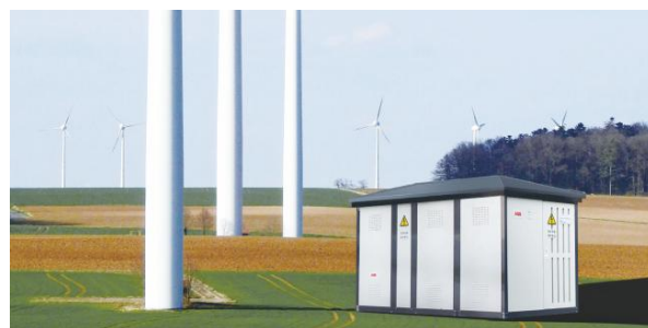
箱式变电站 box substation
